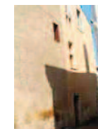
6 encadrement porte baie 1er etages et petites fenetr...
